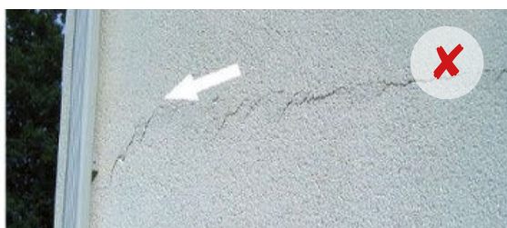
Cisaillage qui se produit à la jonction entre le plancher et la maçonnerie.
