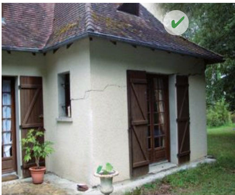
Fissurations en escalier sur un angle de maison caractéristiques d'un tassement différentiel d'un ouvrage du fait du mouvement du terrain.
